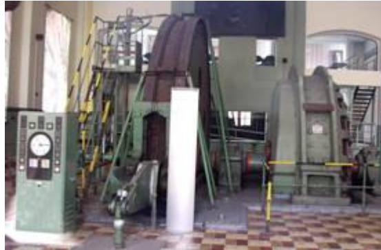
Foto A.B. Motoren liftkabels
